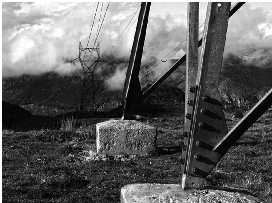
Torres de alta tensión en Tarna.
